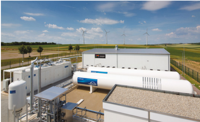
Bild 1.1 Energiepark Mainz mit Wasserstoffspeichern: Der Wasserstoff wird mittels Elektrolyse und erneuerbarem Strom aus regionalen Wind- und Solaranlagen erzeugt (© mit freundlicher Genehmigung der Mainzer Stadtwerke AG).
